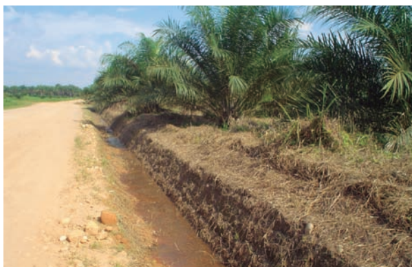
Figura 20. Carreteras y canales para drenaje. Palmas Monterrey. Foto: Nolver Arias.
