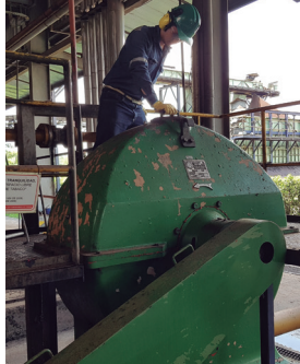
Revisión del estado de equipos y válvulas
