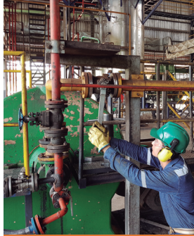
Descarga de la centrífuga
